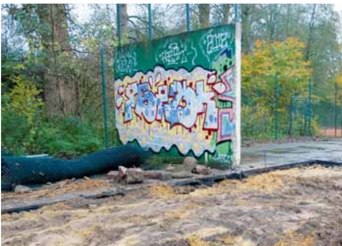
Die vorhandene Ballwand ist noch halb so breit wie vorher.
